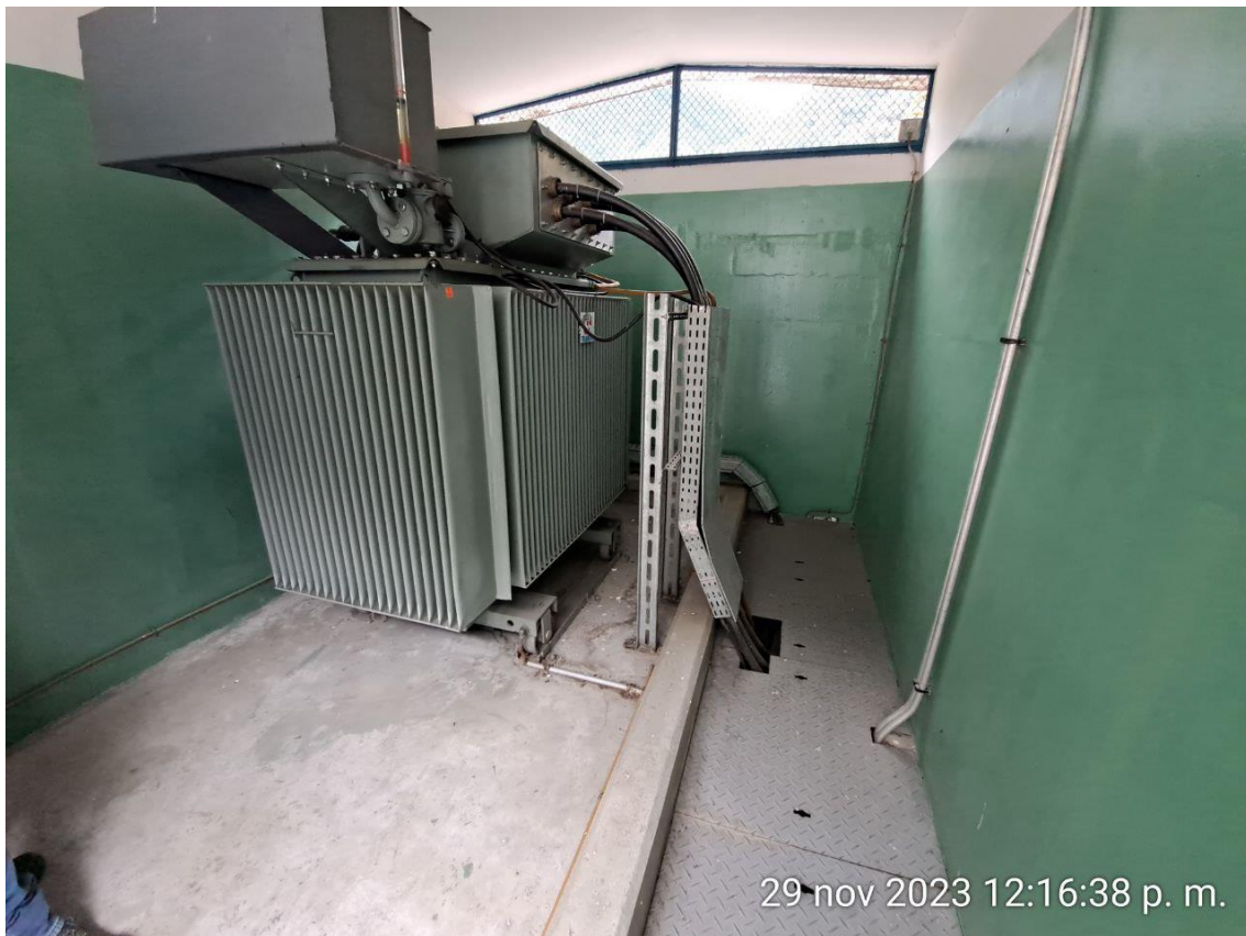
Fotografía N° 12. Contención de Trasformador de Servicios Auxiliares.
