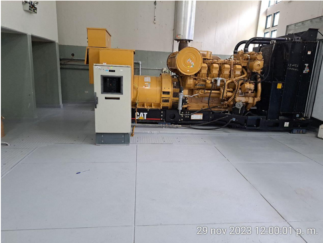
Fotografía N° 9. Ambiente de Grupo de Emergencia
