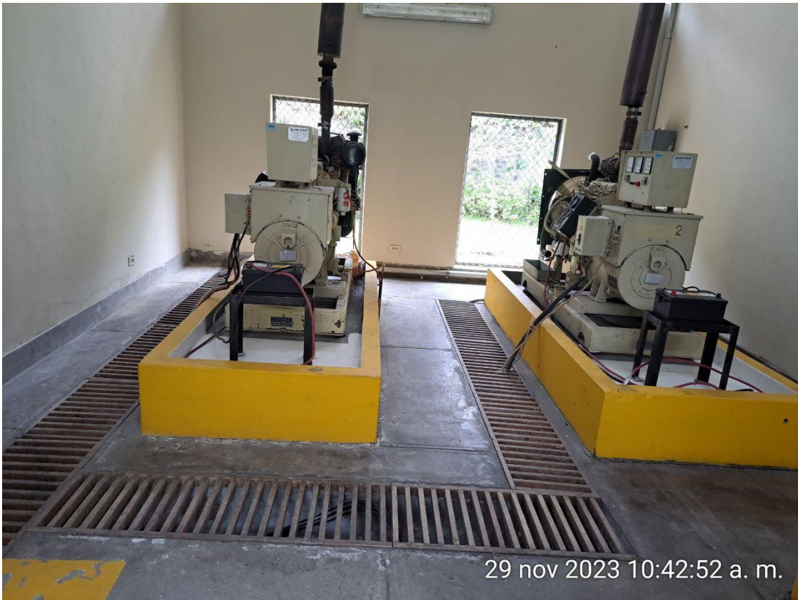
Fotografía N° 7. Ambiente de Grupo de Emergencia – Villa
