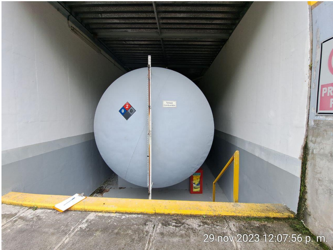
Fotografía N° 11. Ambiente de contención de tanque de combustible
