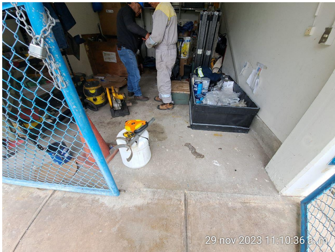
Fotografía N° 8. Almacén de Bombas
