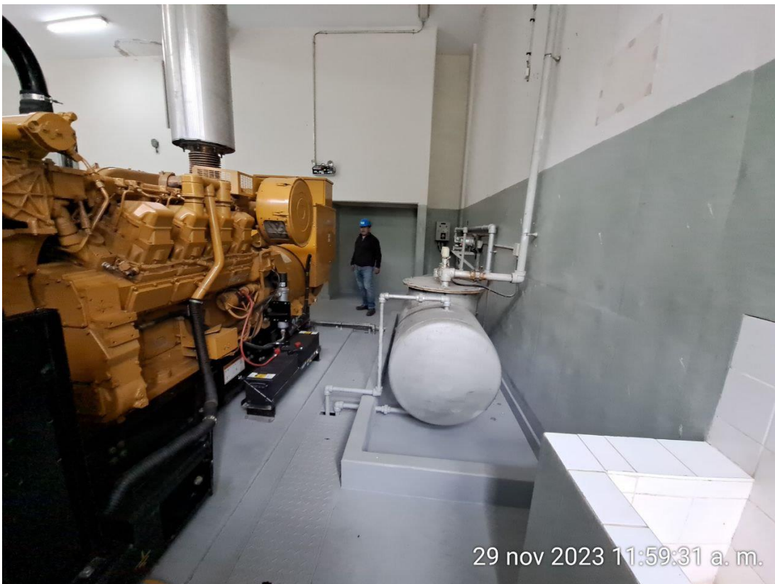
Fotografía N° 10. Ambiente de Grupo de Emergencia
